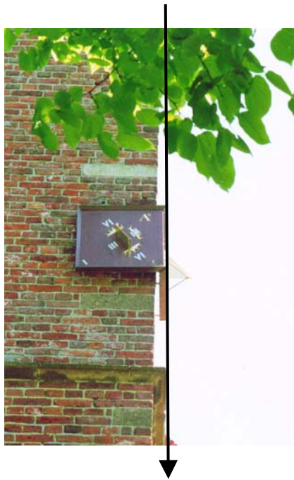
De bevestiging van de wijzers toont scheefte en Oosting van de toren. Opn. 11 mei 2000 ER
